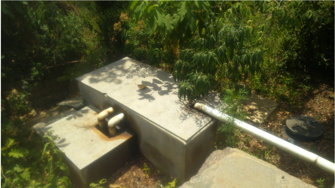
Foto 9: Caixa separadora de água e óleo e fossa séptica. Data: 21/01/2015.
